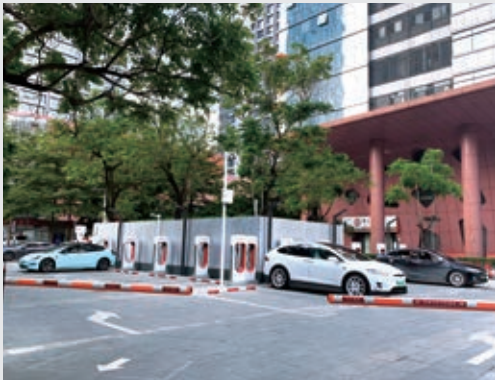
▲ 在金谷园区引入特斯拉第1,000个超级充电站
