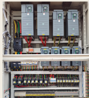
排油烟风机设备安装时控制器
